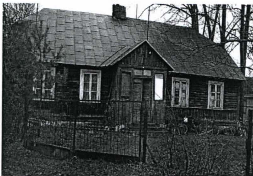
Fot. 2: Stara przedwojenna świetlica nadaje się tylko do rozbiórki. Na jej miejsce proponujemy zbudować nowoczesny budynek z przeznaczeniem na rekreację i zebrania wiejskie.
