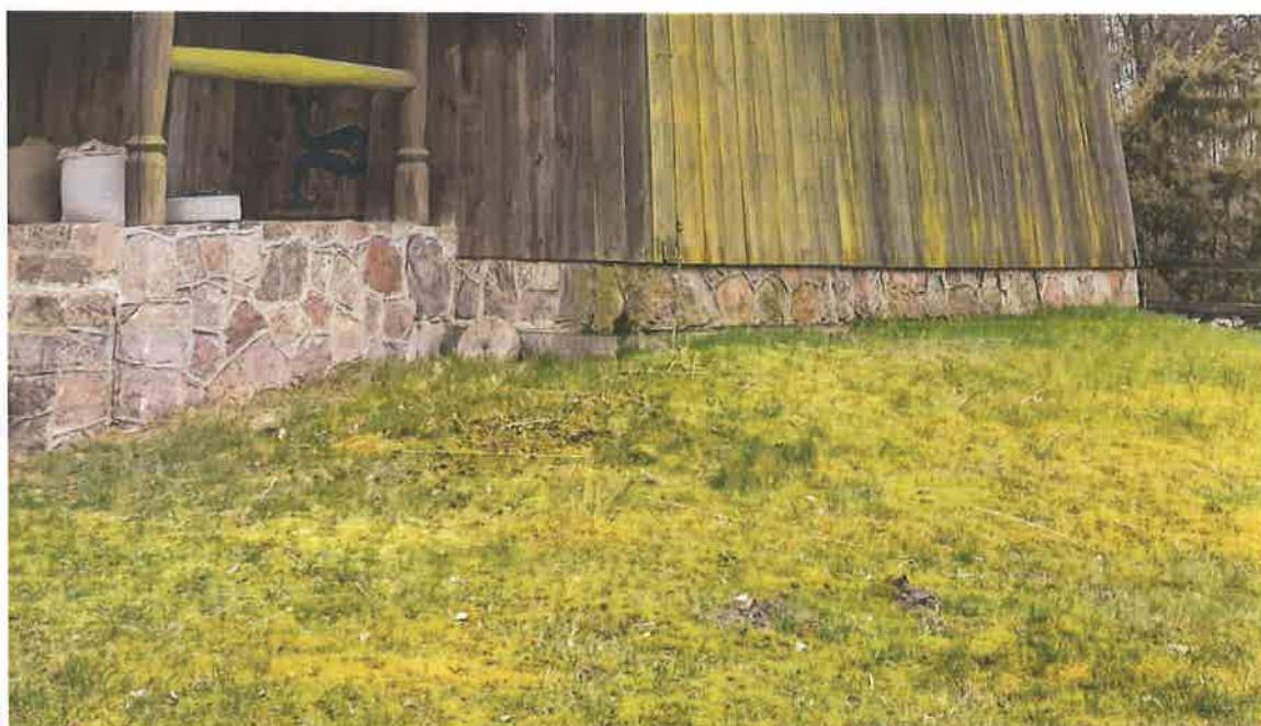
Fot.12. Widok na stan zachowania kamiennej podmurówki (opracowanie: własne)
