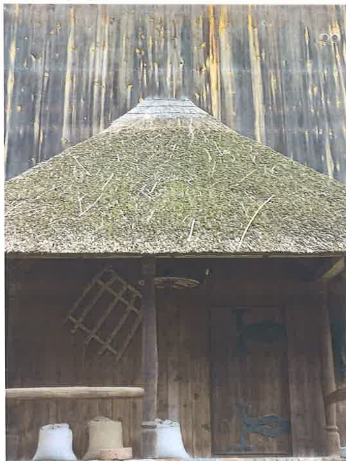
Fot.11. Widok na stan zachowania strzechy nad gankiem (opracowanie: własne)
