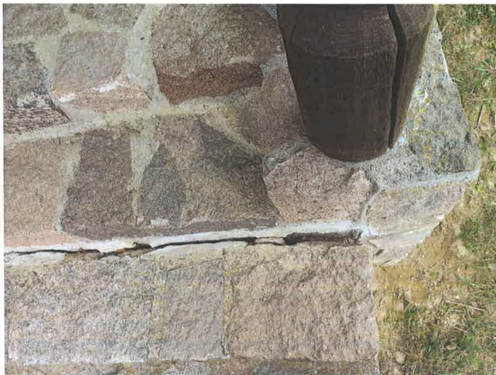
Fot.12. Widok na odspojenie betonowej spoiny przy schodach wejściowych (opracowanie: własne)
