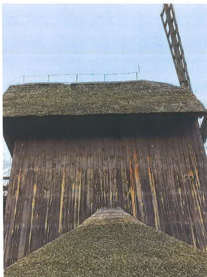
Fot.8. Zbliżenie na widok stanu zachowania drewnianego poszycia ścian oraz strzechę (opracowanie: własne)
