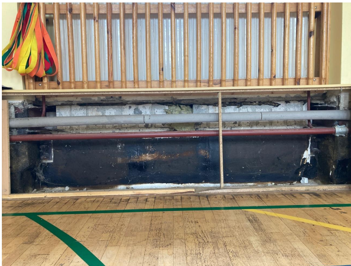
Rys. nr 3 – odsłonięte rury centralnego ogrzewania
