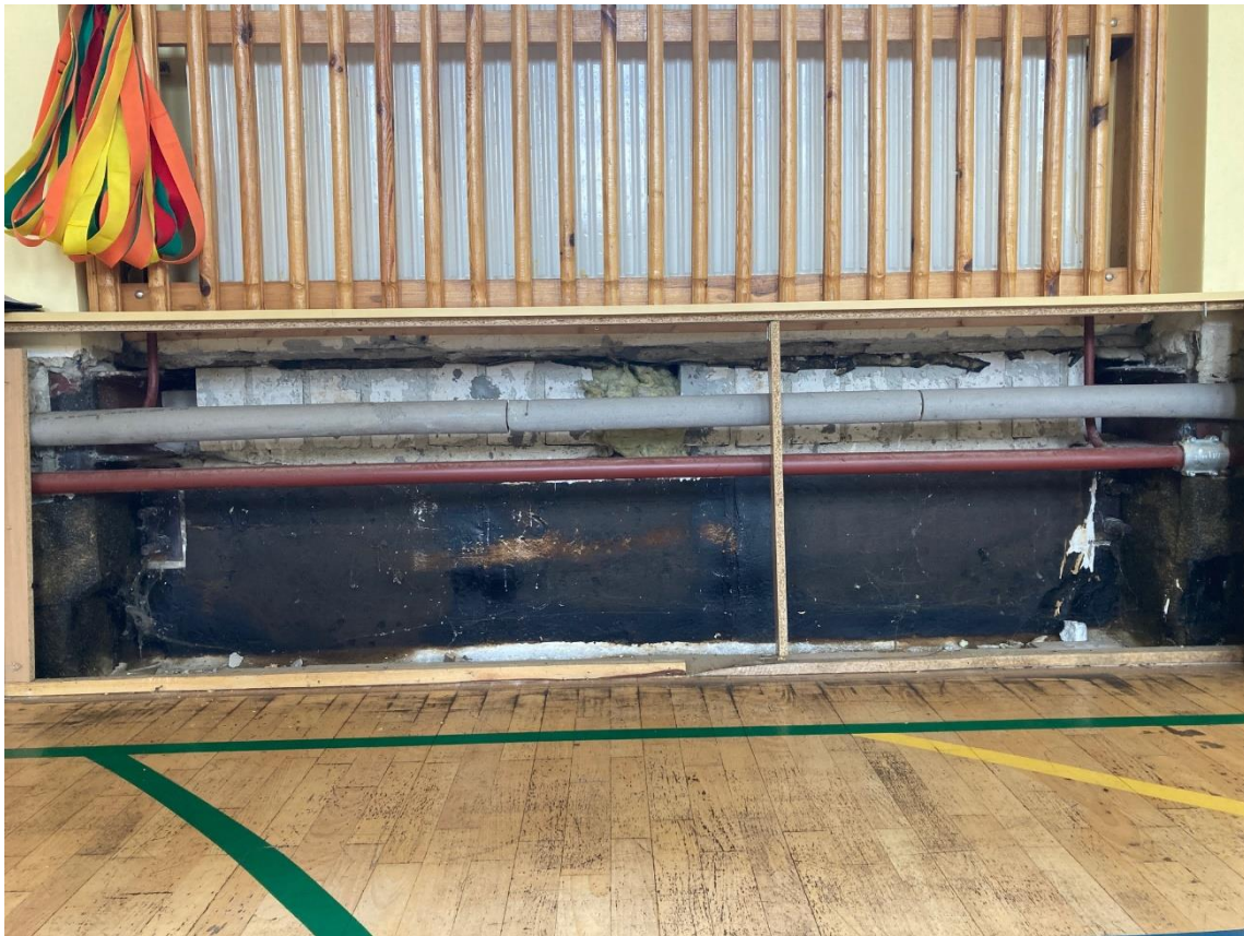
Rys. nr 3 – odsłonięte rury centralnego ogrzewania
