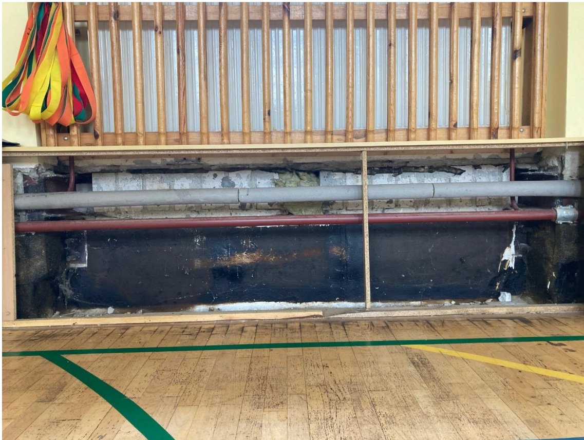
Rys. nr 3 – odsłonięte rury centralnego ogrzewania
