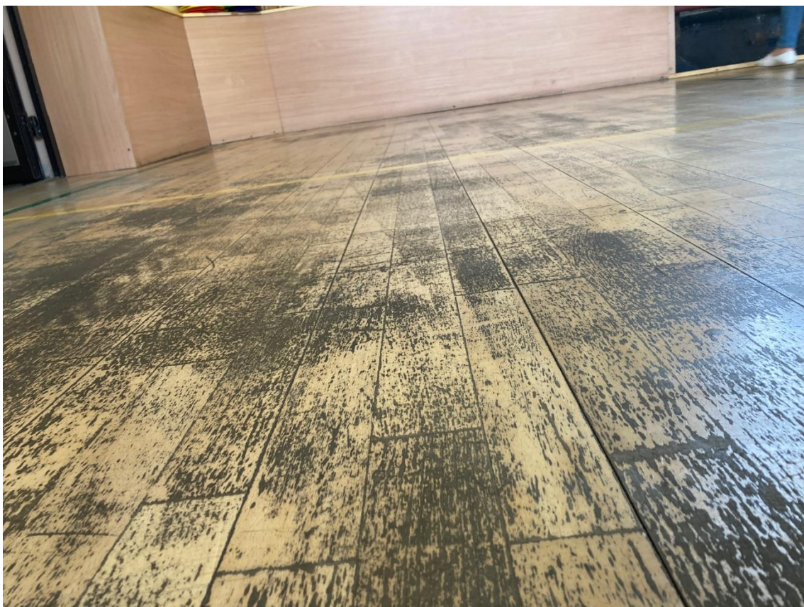
Rys. nr 2 – obecny stan podłogi
